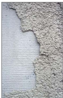
Фото 2. Разрушение полимерной штукатурки[17]
